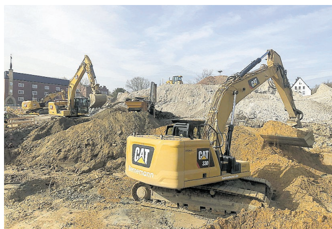
Mehrere Bagger fressen sich seit Wochen durch das Erdreich auf dem Areal am Busbahnhof, um die alten Fundamente des Hertener-Forums zu entfernen.
